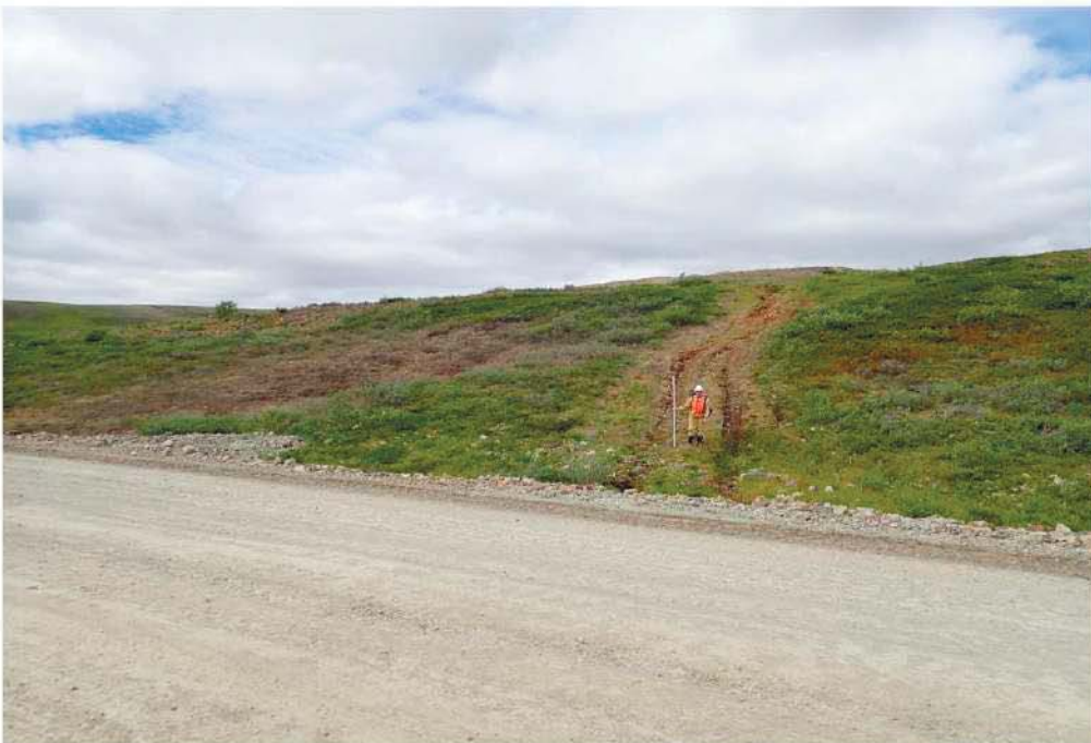
Рис. 17. Осмотренные техногенные раздернованные участки по правому борту р. Ср. Кайемравеем. Начальный участок автодороги Купол-Морошка. Вид с востока.
