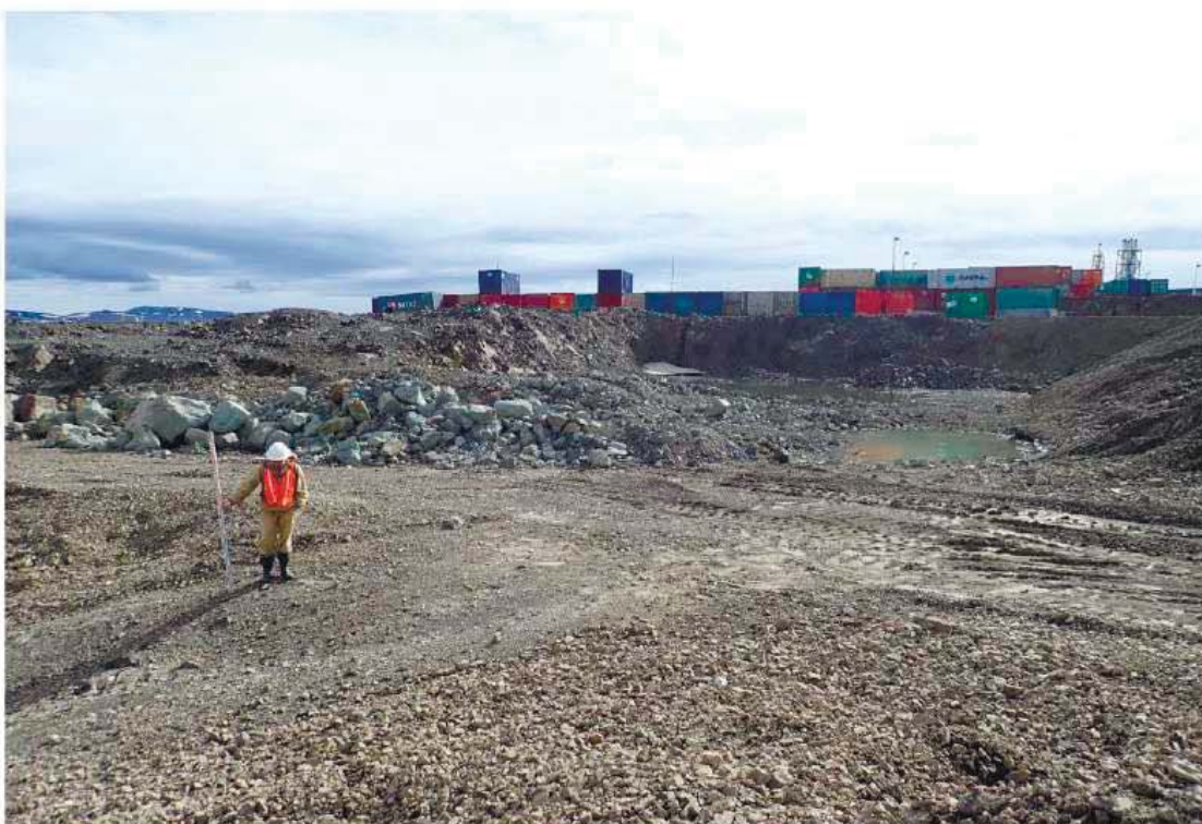
Рис. 483. Проектируемая площадка подстанции - конечная точка трассы обследованного объекта «ВЛ 110кВ Яракваам-Купол». Вид с севера.
