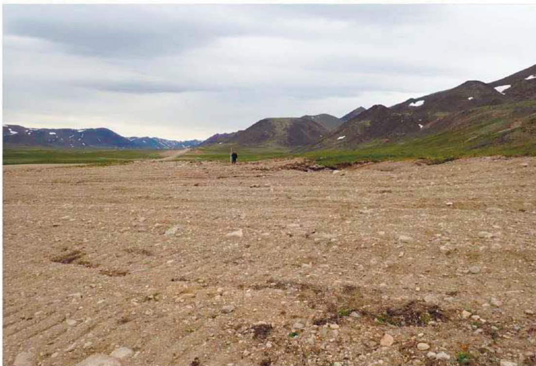
Рис. 120. Осмотренные участки с техногенно нарушенной естественной поверхностью по левому борту долины р. Прав. Яракваам. Северная часть Участка 3 трассы обследованного объекта «ВЛ 110кВ Яракваам-Купол». Вид с севера.
