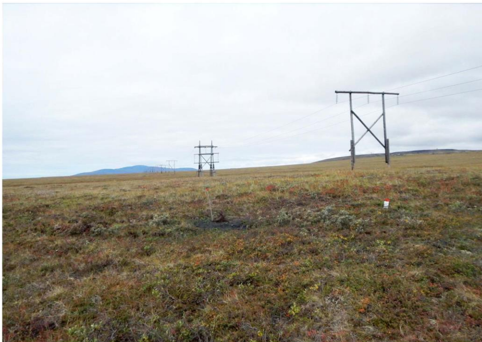
Рис. 20. Действующая линия электропередач на участке подключения проектируемой ПС 110/10 кВ. Вид с востока.
