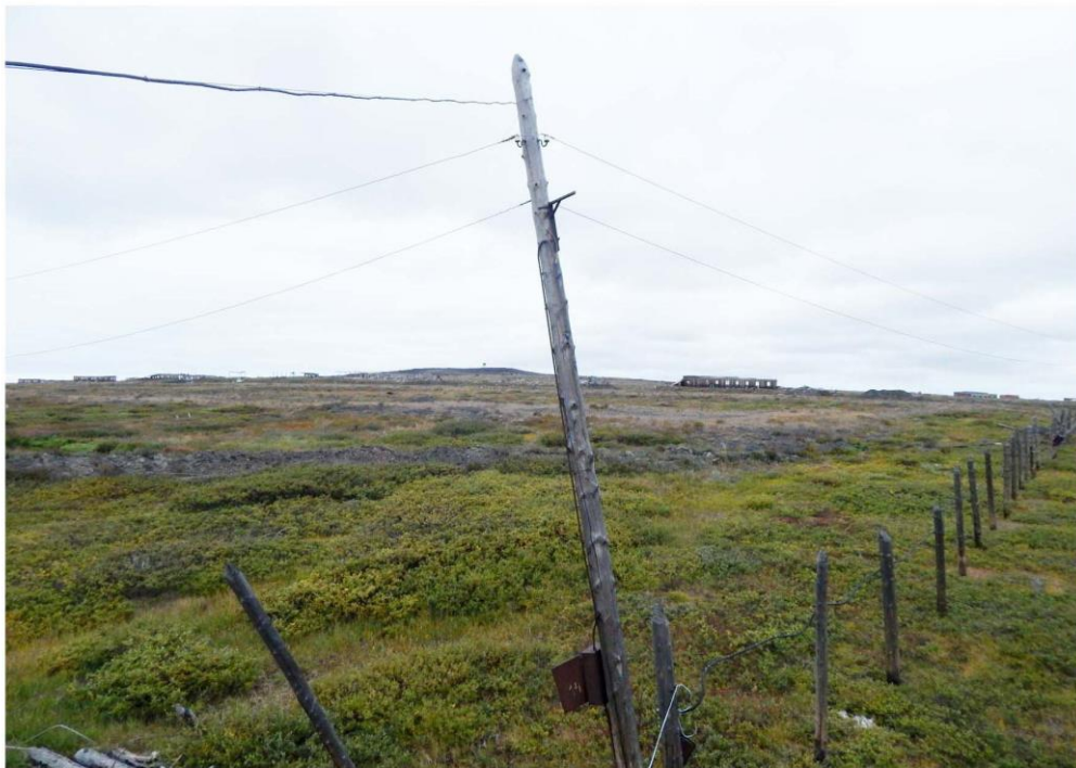
Рис, 114. Вид с юго-востока на финишный участок трассы ВЛ 110 кВ на территории проектируемой базы материального обеспечения.
