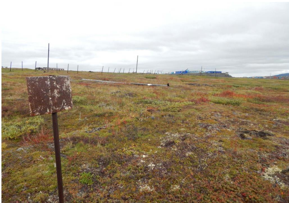
Рис. 106. Вид с юго-запада на место захода трассы ВЛ 110 кВ на территорию проектируемого складского комплекса.
