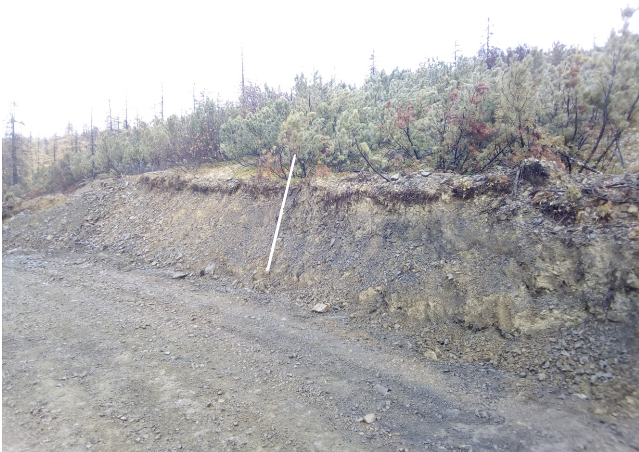
Рис. 18. Баимский ГОК. Проект медного месторождения «Песчанка». Подъездная дорога к посадочной площадке «Баимская». Точка фотофиксации 10. Вид с северо-запада.
