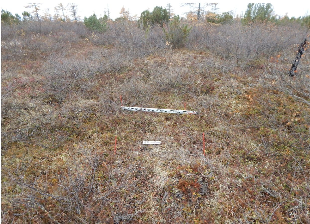
Рис. 50. Баимский ГОК. Проект медного месторождения «Песчанка». Подъездная дорога к посадочной площадке «Баимская». Шурф № 8 перед началом работ. Вид с востока.
