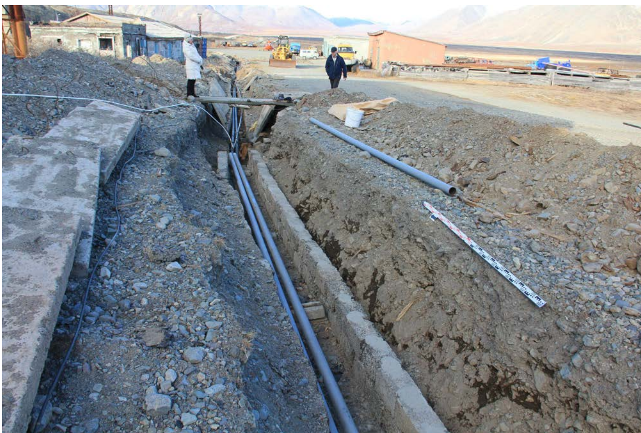
Рис.78. Чукотский АО, городской округ Эгвекино, 2022 год. Проект реконструкции аэропорта “Залив Креста”. Канавы для труб водоснабжения у зданий аэровокзала, гаража, складов. Вид на ССВ. Глубина канавы до 1,8 м.
