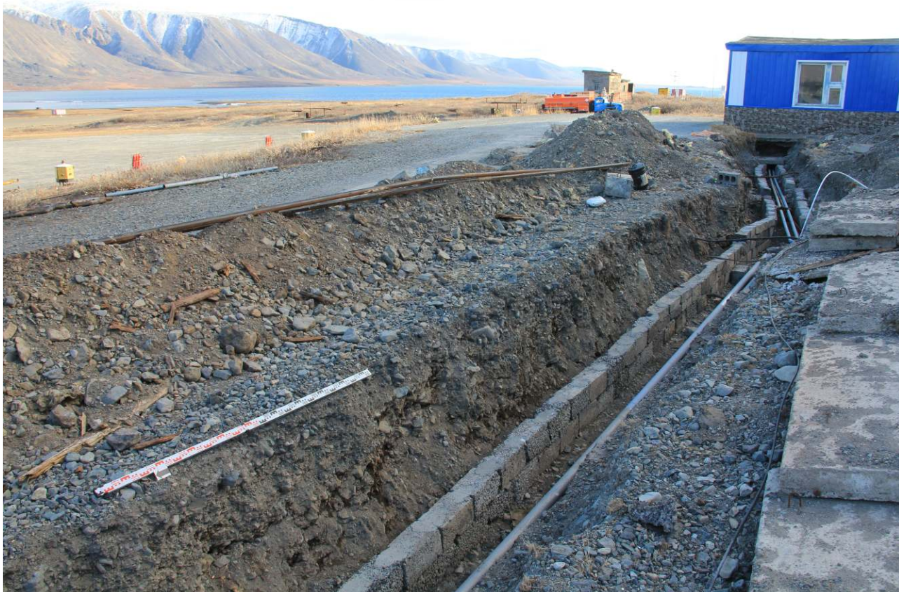
Рис.77. Чукотский АО, городской округ Эгвекино, 2022 год. Проект реконструкции аэропорта “Залив Креста”. Канавы для труб водоснабжения у зданий аэровокзала, гаража, складов. Направление съемки на ЮЮВ. На заднем плане крыльцо аэровокзала со стороны перрона.
