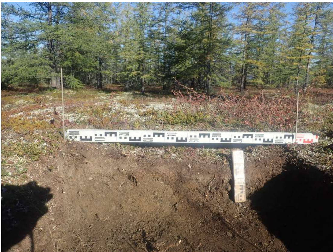
Рис. 464. СВАЭ-2022. Чукотский АО. Электроснабжение Баимского ГОК. ВЛ 330 кВ ПП Билибино-Баимский ГОК №2. Борт шурфа 54. Вид с юга.
