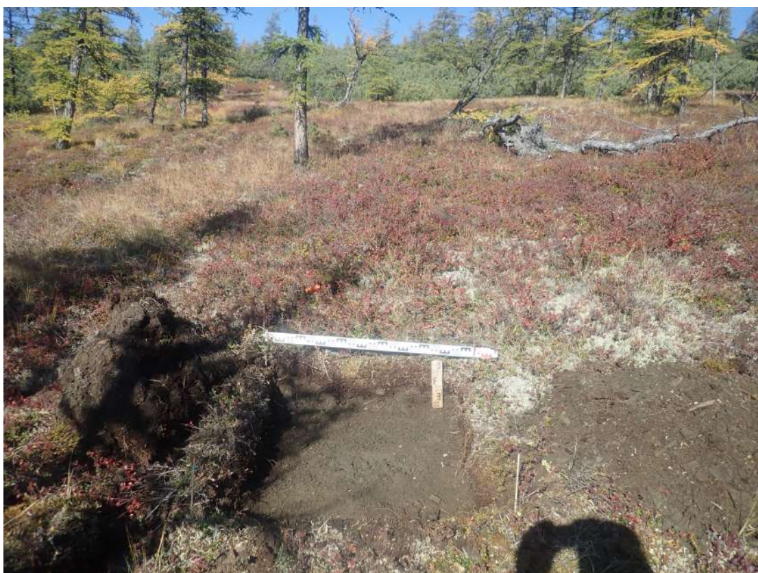
Рис. 301. СВАЭ-2022. Чукотский АО. Электроснабжение Баимского ГОК. ВЛ 330 кВ ПП Билибино-Баимский ГОК №2. Шурф 10 после вскрытия. Вид с запада.
