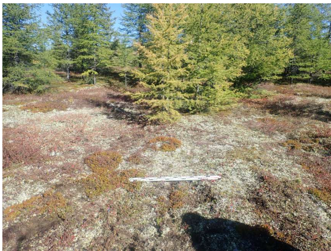
Рис. 507. СВАЭ-2022. Чукотский АО. Электроснабжение Баимского ГОК. ВЛ 330 кВ ПП Билибино-Баимский ГОК №2. Рекультивация шурфа 65. Вид с юга.
