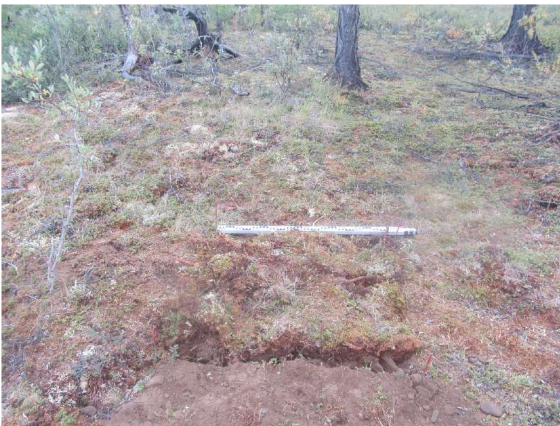
Рис. 381. СВАЭ-2022. Чукотский АО. Электроснабжение Баимского ГОК. ВЛ 330 кВ ПП Билибино-Баимский ГОК №2. Рекультивация шурфа 31. Вид с востока.
