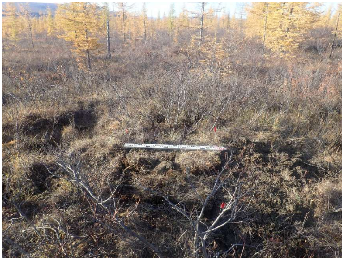
Рис. 323. СВАЭ-2022. Чукотский АО. Электроснабжение Баимского ГОК. ВЛ 330 кВ ПП Билибино-Баимский ГОК №2. Рекультивация шурфа 15. Вид с запада.
