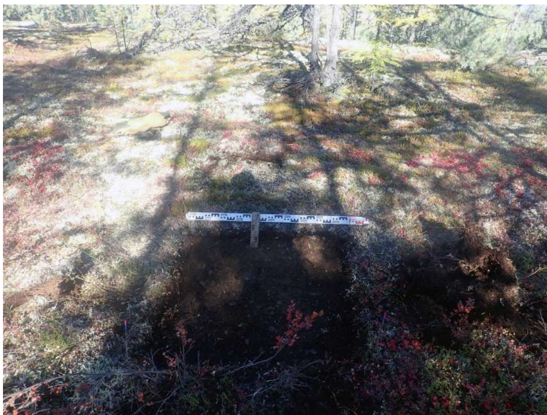
Рис. 459. СВАЭ-2022. Чукотский АО. Электроснабжение Баимского ГОК. ВЛ 330 кВ ПП Билибино-Баимский ГОК №2. Шурф 53 после вскрытия. Вид с востока.
