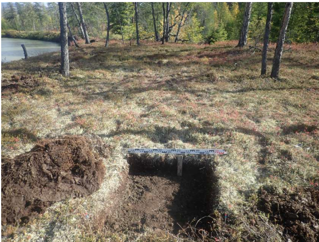
Рис. 385. СВАЭ-2022. Чукотский АО. Электроснабжение Баимского ГОК. ВЛ 330 кВ ПП Билибино-Баимский ГОК №2. Шурф 33 после вскрытия. Вид с юга.
