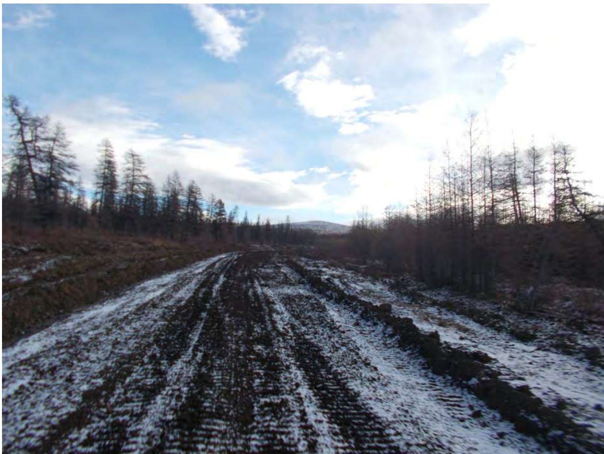
Рис. 159. СВАЭ-2022. Чукотский АО. Электроснабжение Баимского ГОК. ВЛ 330 кВ ПП Билибино-Баимский ГОК №2. ТФ 139 на участке 5. Зимник через Анюйский хребет в створе в районе «105-го км». Вид с юга
