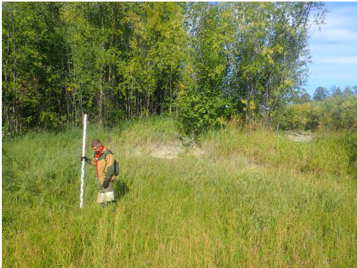
Рис. 252. СВАЭ-2022. Чукотский АО. Электроснабжение Баимского ГОК. ВЛ 330 кВ ПП Билибино-Баимский ГОК №2. ТФ 231 на участке 7. Протока Малого Анюя в пойме в районе перехода створа трассы. Вид с юго-востока.
