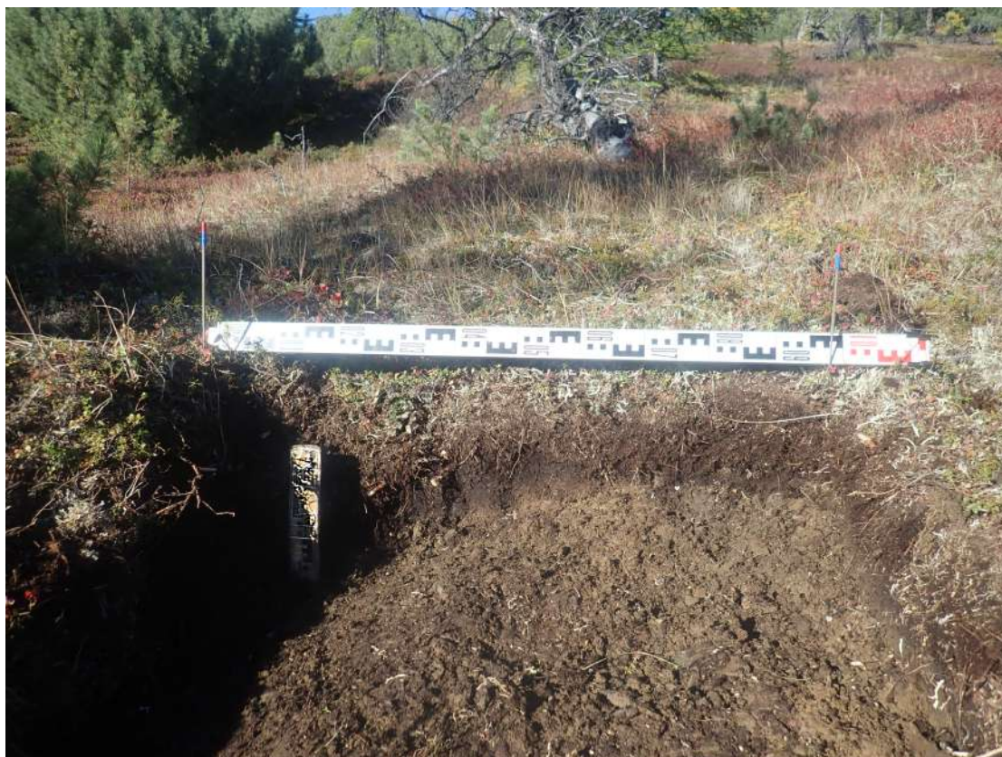
Рис. 448. СВАЭ-2022. Чукотский АО. Электроснабжение Баимского ГОК. ВЛ 330 кВ ПП Билибино-Баимский ГОК №2. Борт шурфа 50. Вид с юга.
