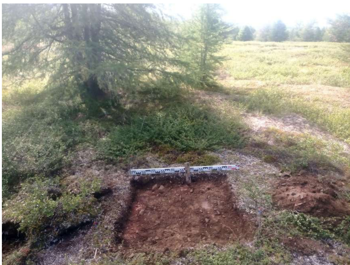
Рис. 519. СВАЭ-2022. Чукотский АО. Электроснабжение Баимского ГОК. ВЛ 330 кВ ПП Билибино-Баимский ГОК №2. Шурф 69 после вскрытия. Вид с запада.
