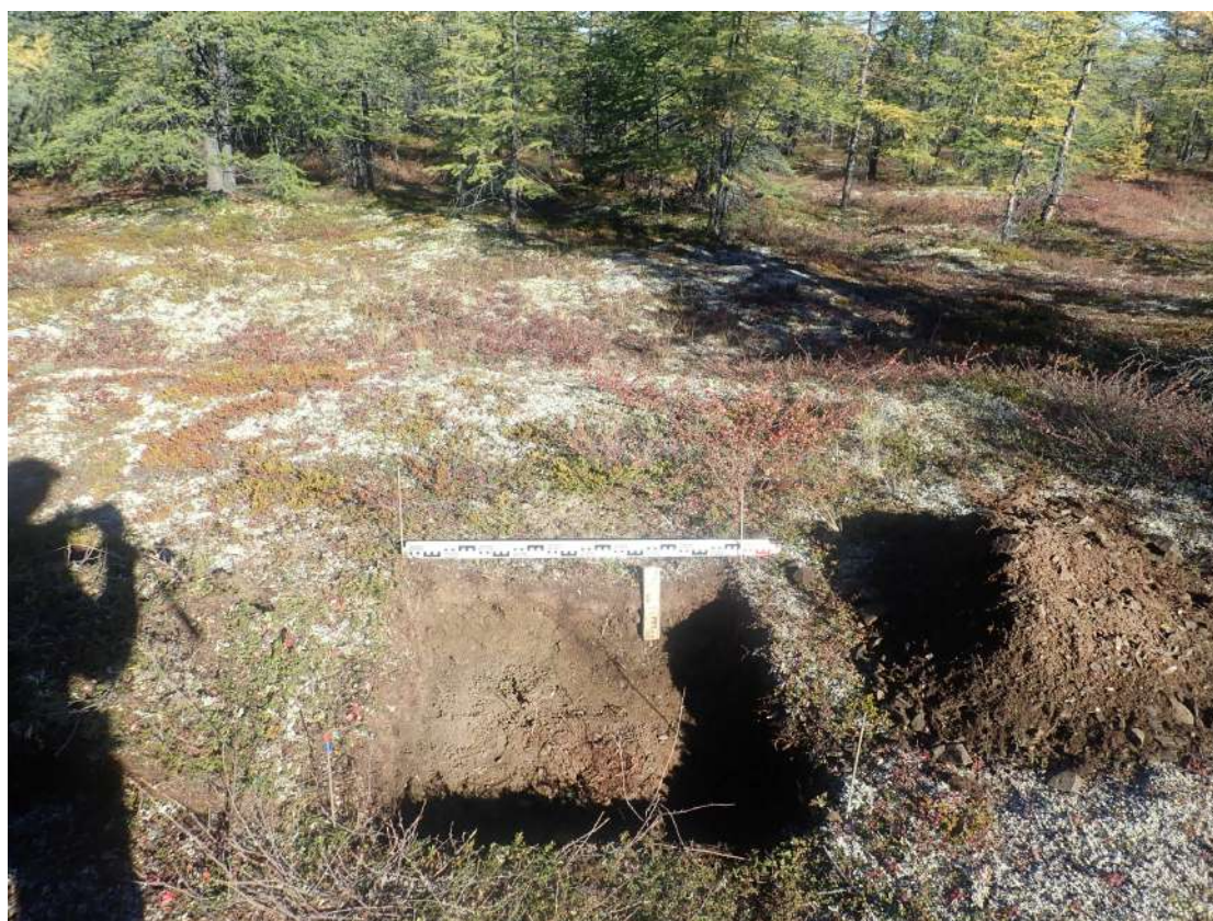
Рис. 479. СВАЭ-2022. Чукотский АО. Электроснабжение Баимского ГОК. ВЛ 330 кВ ПП Билибино-Баимский ГОК №2. Шурф 58 после вскрытия. Вид с запада.
