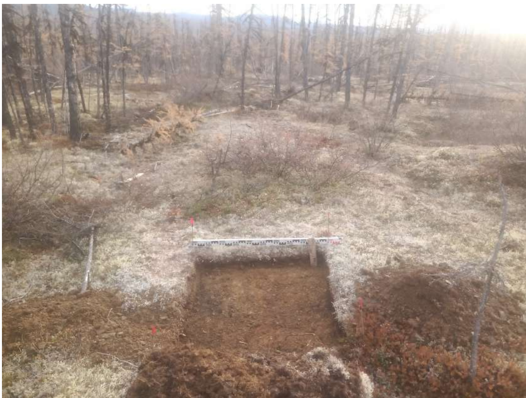
Рис. 363. СВАЭ-2022. Чукотский АО. Электроснабжение Баимского ГОК. ВЛ 330 кВ ПП Билибино-Баимский ГОК №2. Шурф 27 после вскрытия. Вид с востока.
