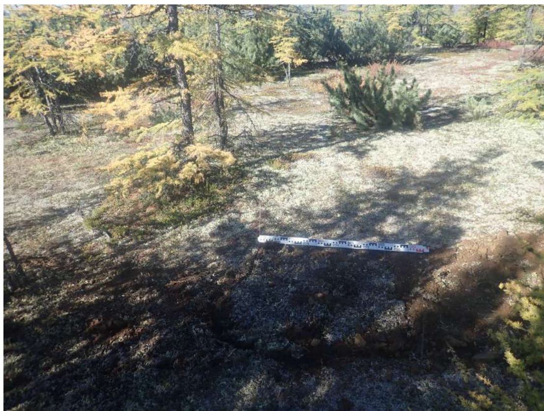
Рис. 445. СВАЭ-2022. Чукотский АО. Электроснабжение Баимского ГОК. ВЛ 330 кВ ПП Билибино-Баимский ГОК №2. Рекультивация шурфа 49. Вид с востока.
