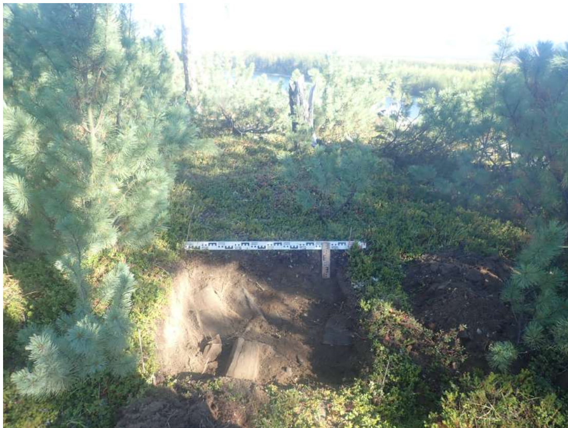
Рис. 533. СВАЭ-2022. Чукотский АО. Электроснабжение Баимского ГОК. ВЛ 330 кВ ПП Билибино-Баимский ГОК №2. Шурф 74 после вскрытия. Вид с севера.
