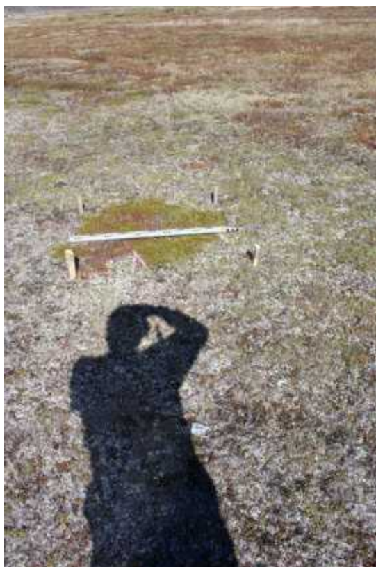
Рис. 26. Чаунский район ЧАО. Начальный участок обследования проектируемой трассы автодороги, район км.822. Долина реки Левтуттуутвеем. Закладка шурфа №4. Вид с Ю.
