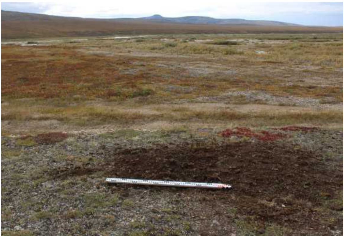
Рис. 223. Чаунский район ЧАО. Проектируемая трасса автодороги. Мыс при слиянии рек Эльпычкыкин и Эльгыкаквын. Рекультивация шурфа №42. Вид с В.
