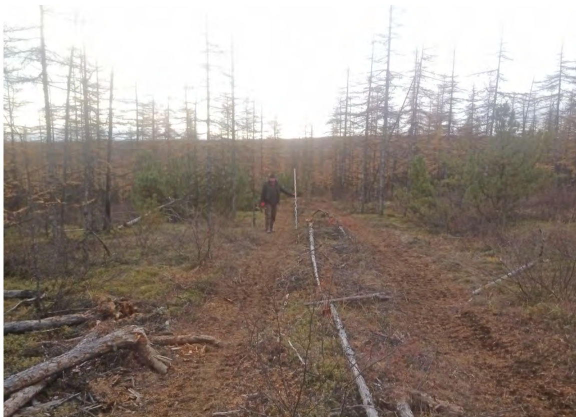
Рис. 271. СВАЭ-2022. Чукотский АО. Строительство автомобильной дороги от Баимского ГОКа до г. Билибино. Карьеры ОПИ. Участок 17. ТФ 162. Вездеходная колея в центральной части площадки карьера. Вид с северо-востока.
