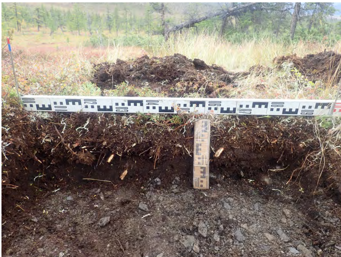
Рис. 316. СВАЭ-2022. Чукотский АО. Строительство автомобильной дороги от Баймского ГОКа до г. Билибино. Карьеры ОПИ. Участок 20. Борт шурфа № 23. Вид с востока.
