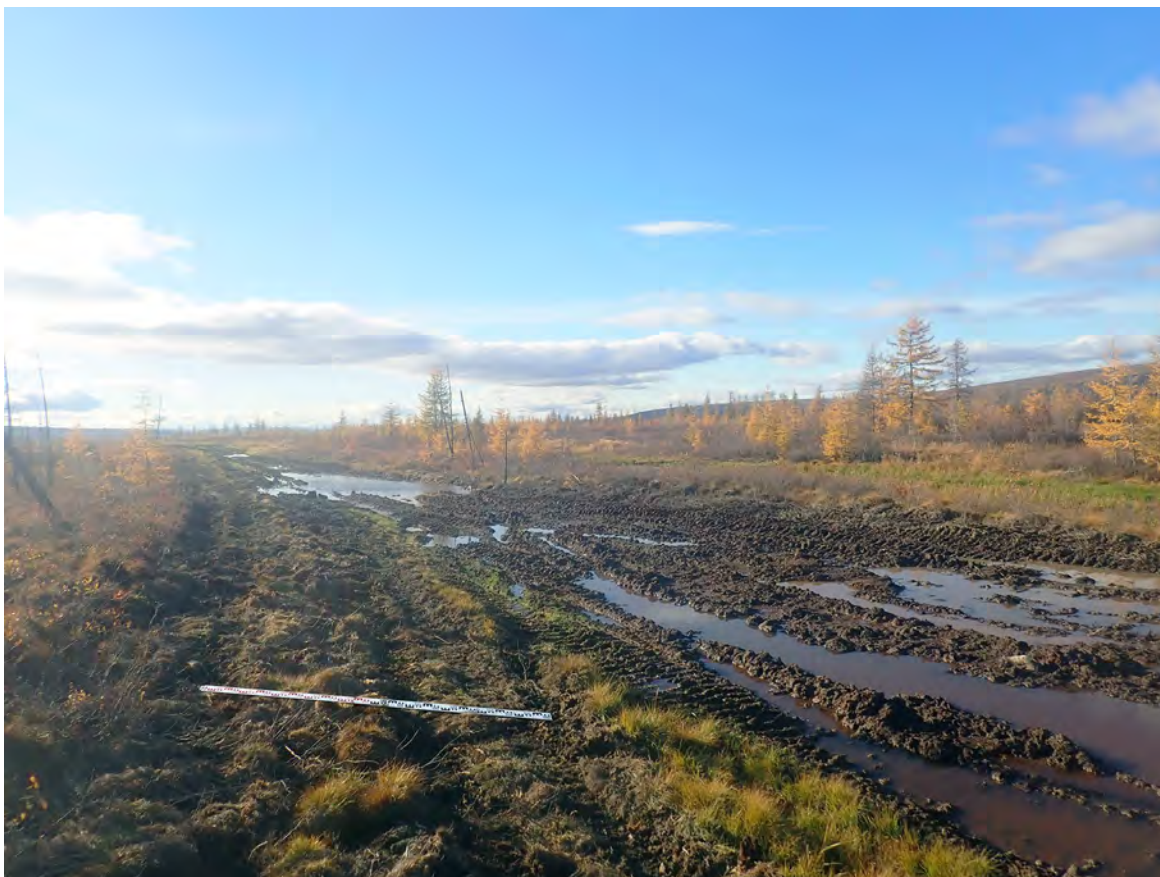
Рис. 530. СВАЭ-2022. Чукотский АО. Строительство автомобильной дороги от Баимского ГОКа до г. Билибино. Карьеры ОПИ. Участок 36. ТФ 331. Автозимник в западной части площадки карьера. Вид с юга.
