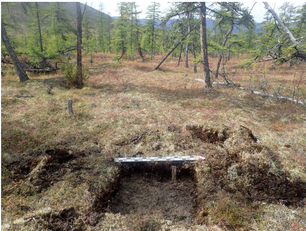
Рис. 19. СВАЭ-2022. Чукотский АО. Строительство автомобильной дороги от Баимского ГОКа до г. Билибино. Карьеры ОПИ. Участок 1. Шурф № 1 после вскрытия. Вид с юга.
