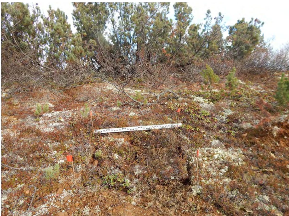
Рис. 84. СВАЭ-2022. Чукотский АО. Строительство автомобильной дороги от г. Билибино до мыса Наглёйнын Карьеры ОПИ. Участок 42. Рекультивация шурфа № 13. Вид с запада.
