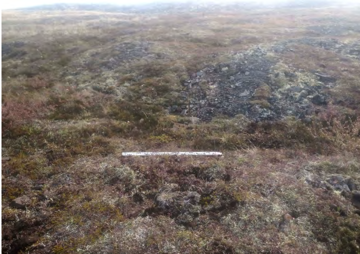
Рис. 366. СВАЭ-2022. Чукотский АО. Строительство автомобильной дороги от г. Билибино до мыса Наглёйнын. Карьеры ОПИ. Участок 62. Рекультивация шурфа № 46. Вид с запада.
