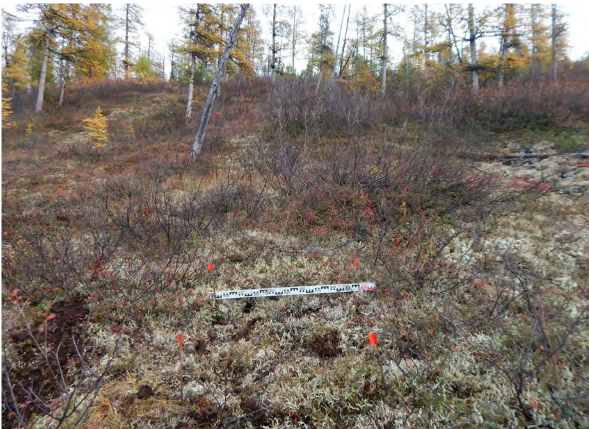
Рис. 170. СВАЭ-2022. Чукотский АО. Строительство автомобильной дороги от г. Билибино до мыса Наглёйнын. Карьеры ОПИ. Участок 45. Рекультивация шурфа № 27. Вид с востока.
