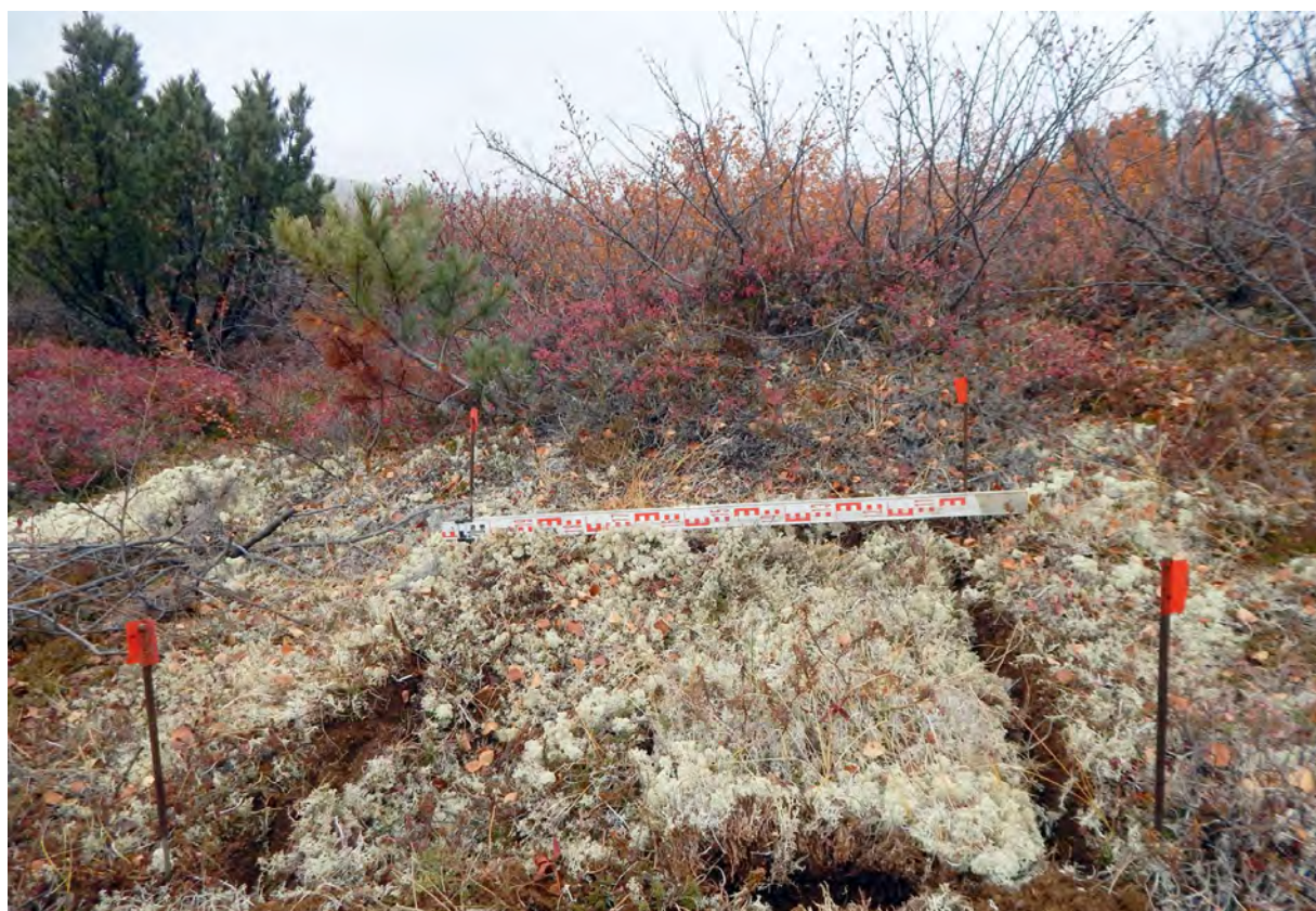
Рис. 120. СВАЭ-2022. Чукотский АО. Строительство автомобильной дороги от г. Билибино до мыса Наглёйнын. Карьеры ОПИ. Участок 43. Рекультивация шурфа № 20. Вид с севера.
