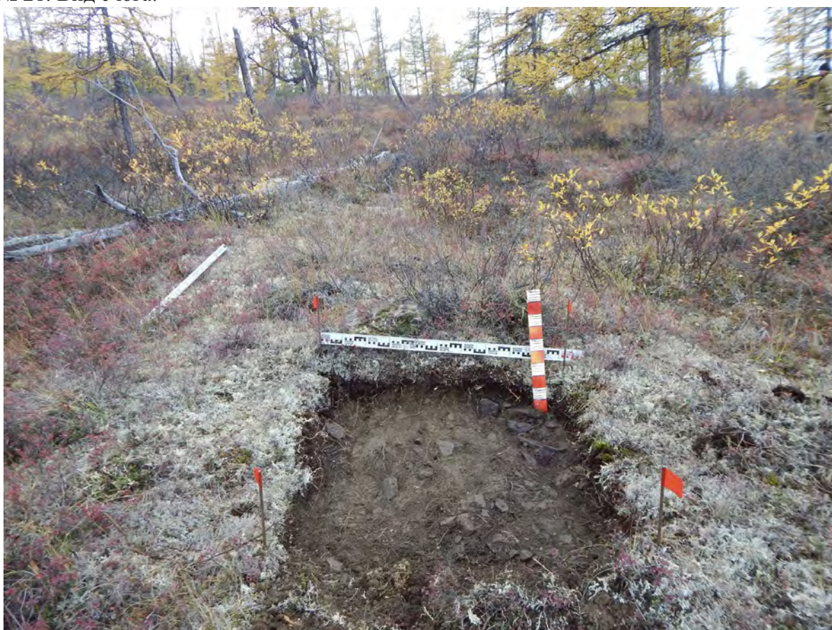
Рис. 134. СВАЭ-2022. Чукотский АО. Строительство автомобильной дороги от г. Билибино до мыса Наглёйнын. Карьеры ОПИ. Участок 44. Шурф № 21 после вскрытия. Вид с юга.
