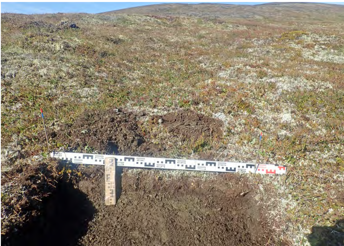
Рис. 401. СВАЭ-2022. Чукотский АО. Строительство автомобильной дороги от г. Билибино до мыса Наглёйнын. Карьеры ОПИ. Участок 65. Борт шурфа № 48. Вид с юга.
