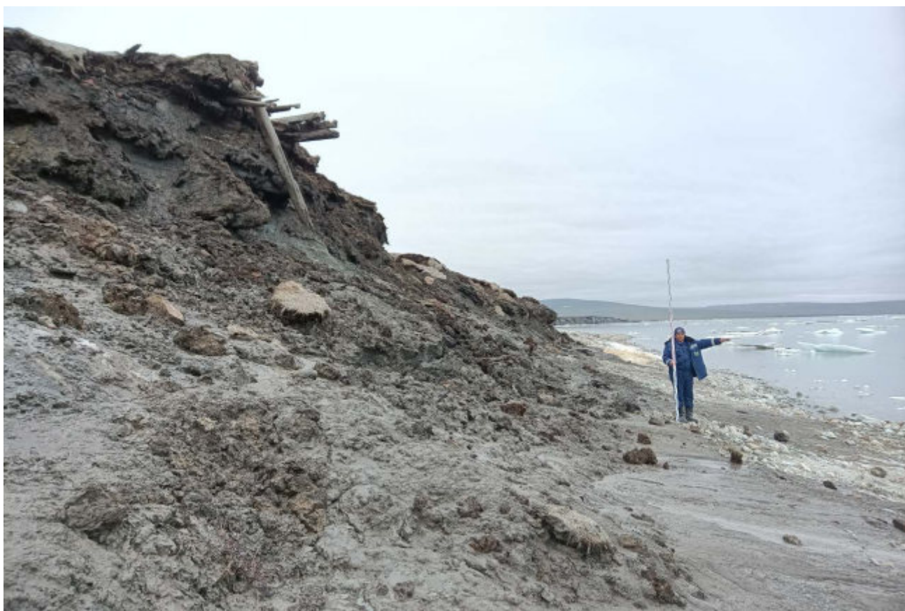
Рис. 455. Чукотский АО, городской округ Певек (Чаунский район), Месторождение “Ручей Факторийный”, 2023 год. Устье руч. Факторийный (за границами участка работ). Разрушающийся береговой обрыв под фундаментом строения. Вид на
