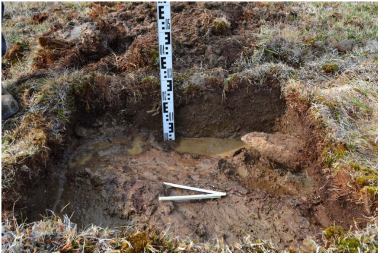
Рис. 342. Чукотский АО, городской округ Певек (Чаунский район), Месторождение “Ручей Факторийный”, 2023 год. Шурф 66. Фотофиксация западного борта.
