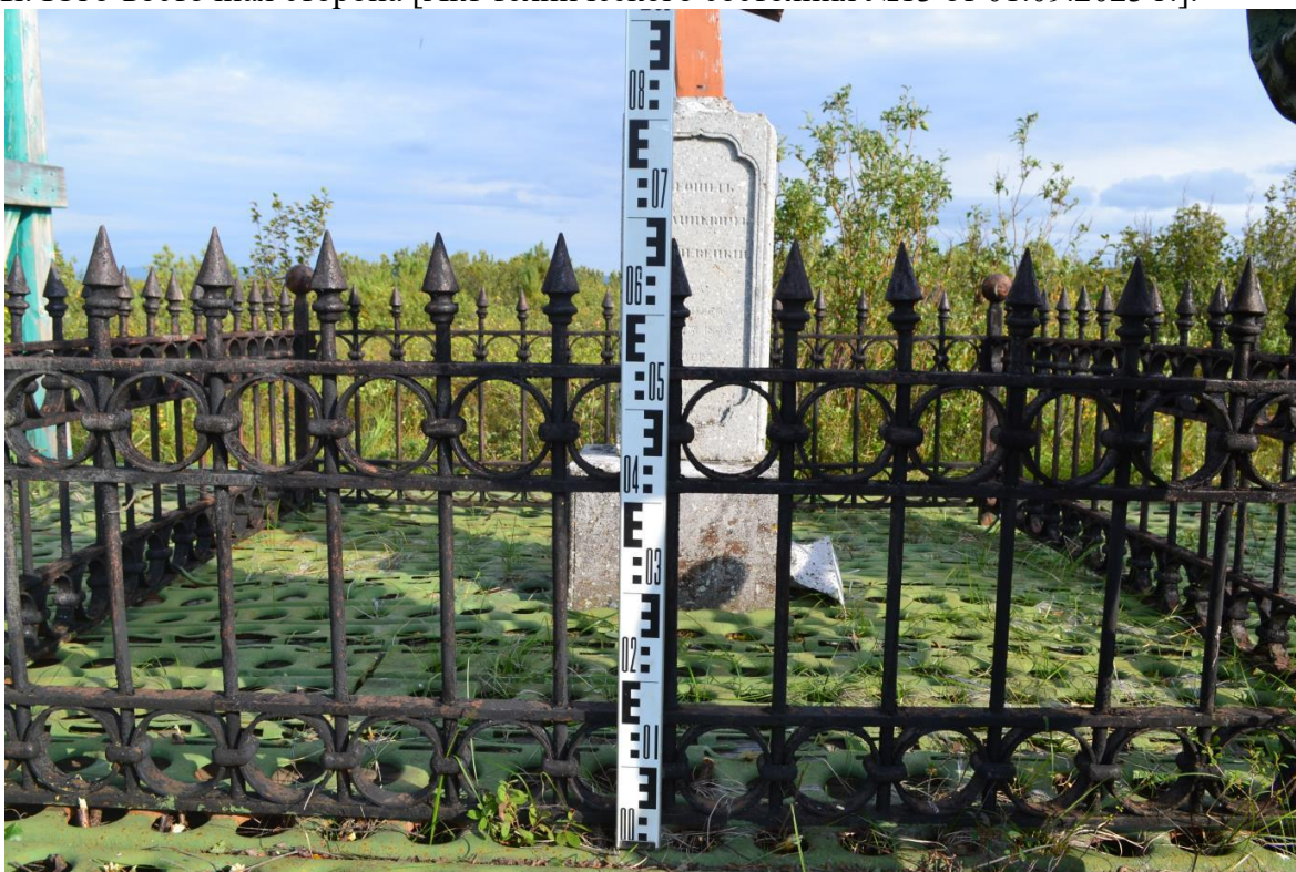
Рис. 6. Анадырский район, р. Майн. Современное состояние ВОКН «Могила Гриневецкого Леонида Францевича (1853-1891)» по состоянию на 01.09.2023 г. Кованая ограда. Юго-восточная сторона [Акт технического состояния №13 от 01.09.2023 г.].
