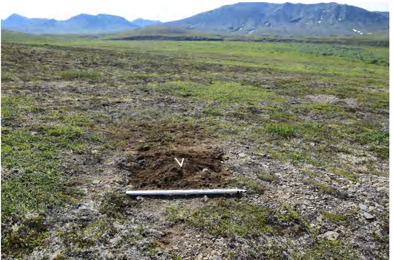
Рис. 32. Чукотский АО, Анадырский р-н, проект “Месторождение Амаамское (участок Западный)”, 2024 г. Шурф №5 после засыпки.
