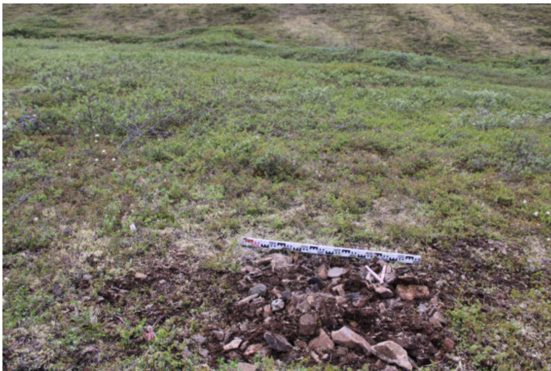
Рис. 118. Билибинский район ЧАО. Земельный участок объекта: «Склад АХОВ». Южный сектор землеотвода. Рекультивация шурфа №6. Вид с С.
